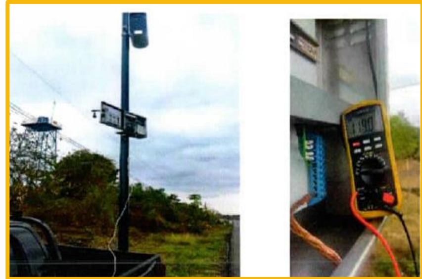
Medición de voltaje de los dispositivos
